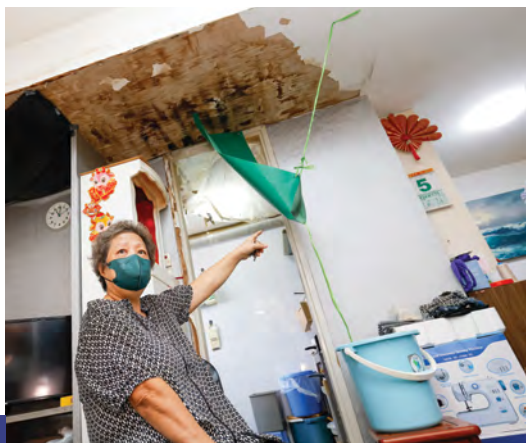
(左圖) 不少單位破爛失修，居民深受滲水問題困擾。
