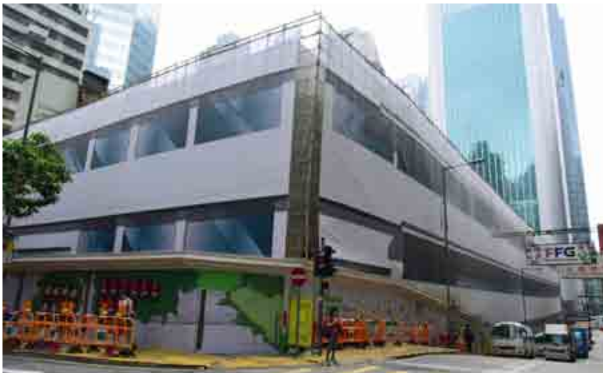
中環街市活化工程現已進入前期工程階段，工程主要於皇后大道中附近進行，日後將成為入口小廣場的休憩空間。
