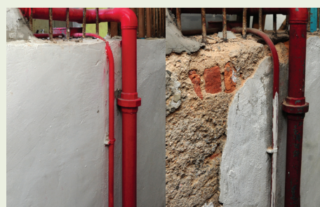
■ 市建局的樓宇維修綜合支援計劃協助業主改善樓宇狀況。
