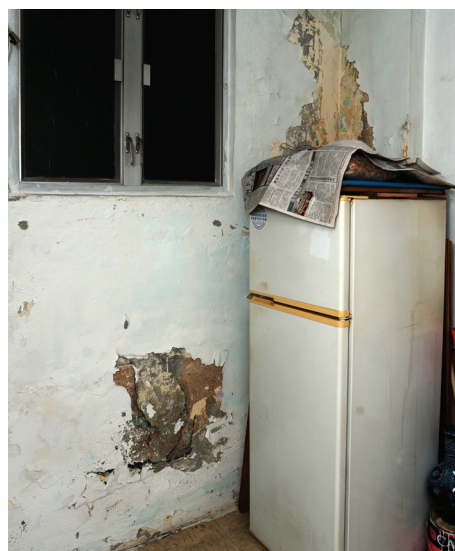
■ 樓宇狀況殘破失修。
