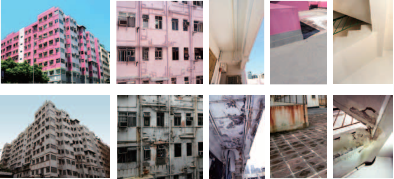
觀塘雲漢大樓：復修前後的面貌。
