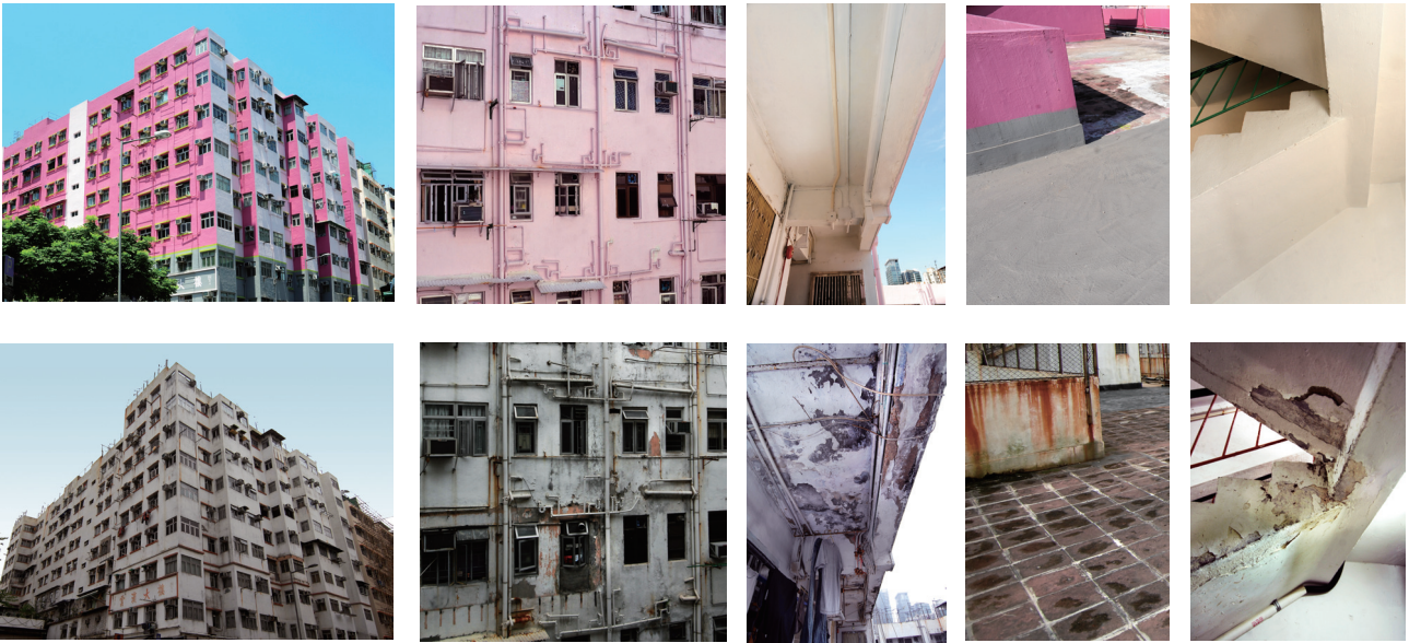
觀塘雲漢大樓：復修前後的面貌。
